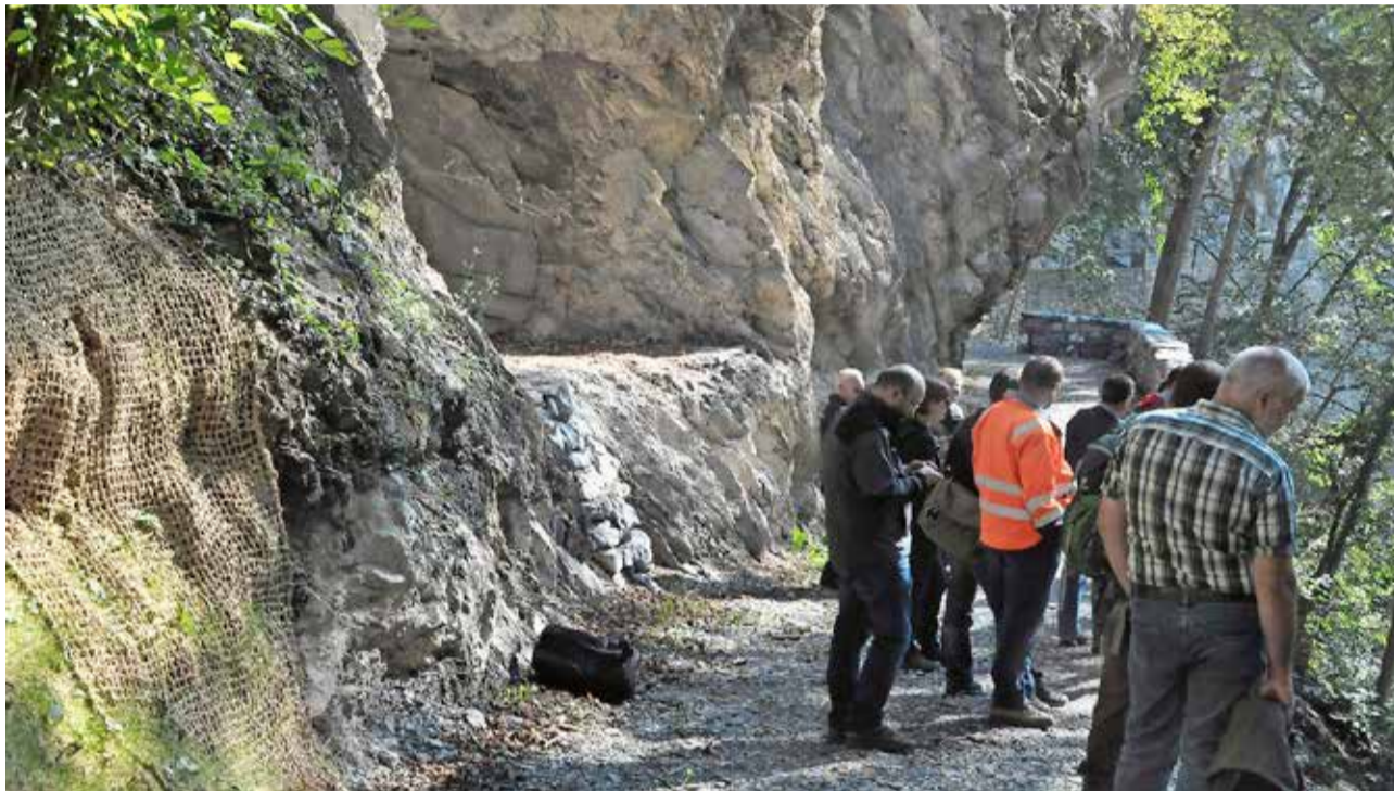
Schwierigste Stelle des Projekts: Nahe der Hohwand war der Weg mit bis zu zwei Metern Schutt überführt.
